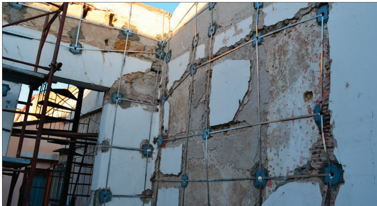
Ex Collegio di San Rocco, Palermo – Consolidamento pareti con sistema CAM, messa in sicurezza capriate con sistema a funi di acciaio e barre Dywidag
